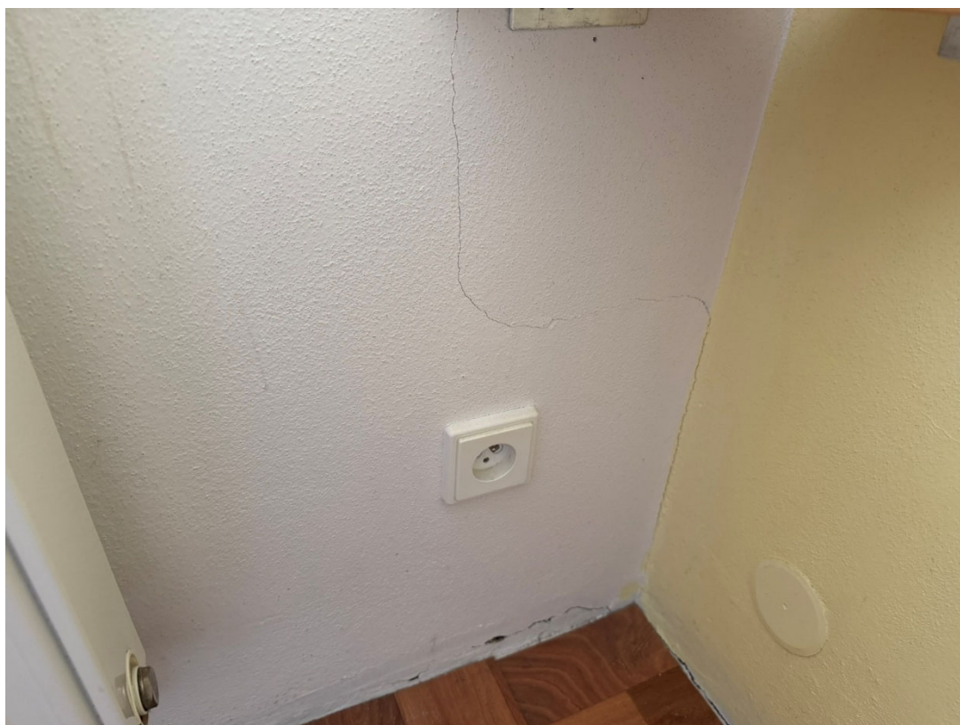
Praskliny v přístavbě
