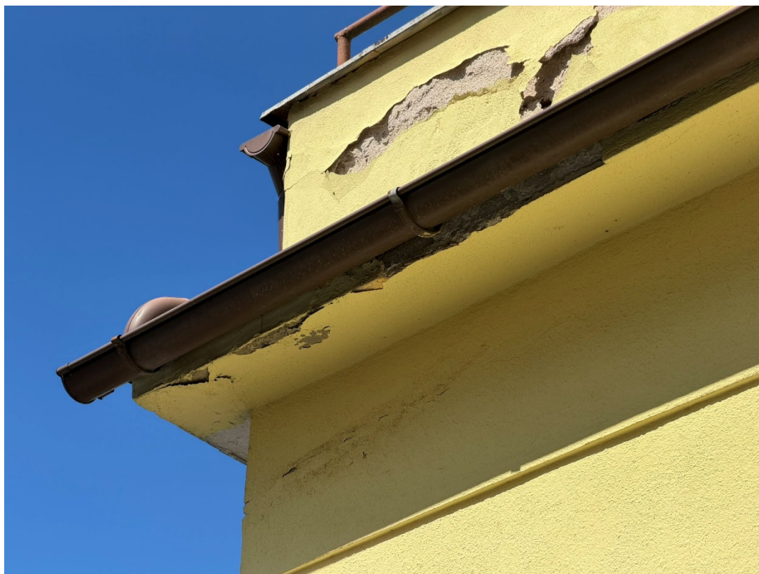
Poškození fasádní omítky
