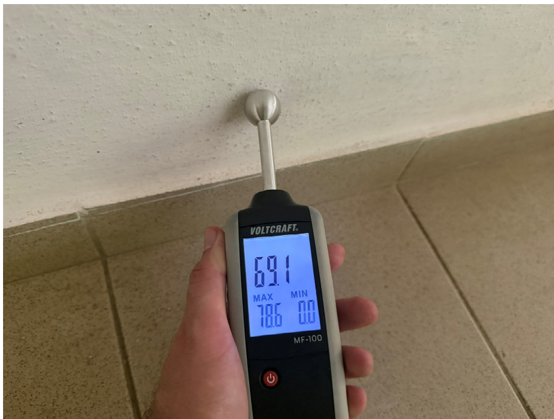
Úroveň vlhkosti ve zdivu, max hodnota pro suchou stěnu do 35%
