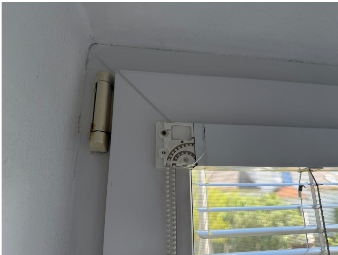
Chybějící krytka mechanismu žaluzií
