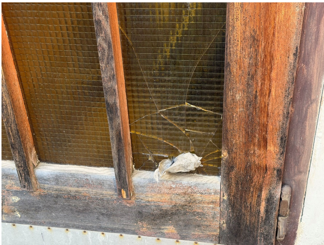
Prasklina na zasklení
