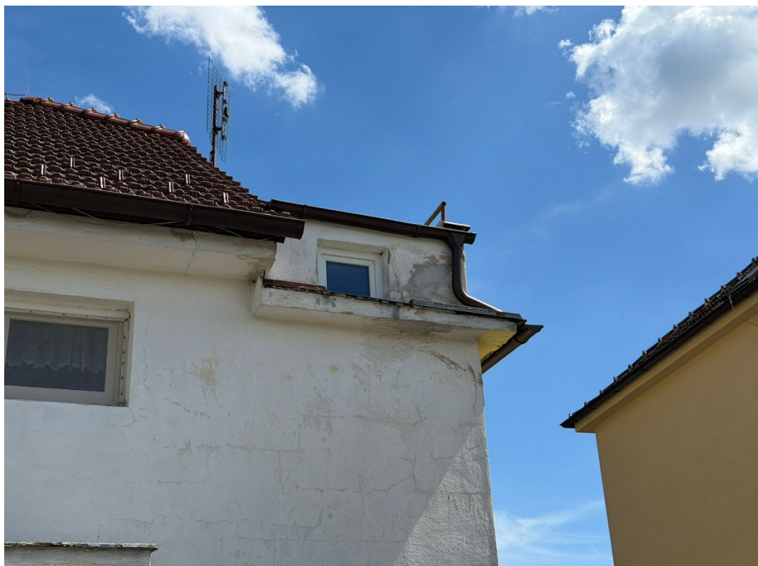
Roh budovy, kde dochází k zatékání dešťové vody
