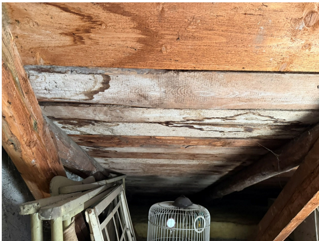
Pozůstatky po zatečení dešťové vody
