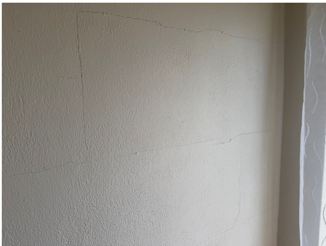
Praskliny v přístavbě
